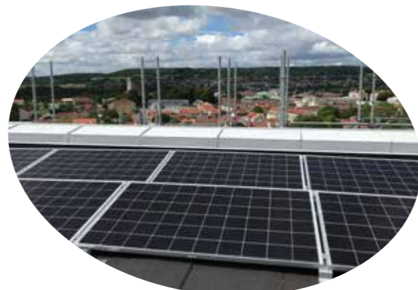
Solceller på flera av våra fastigheter
